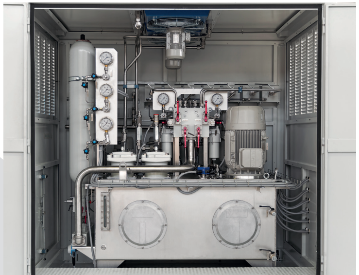
Turbine a vapore – HPU con cabinato
